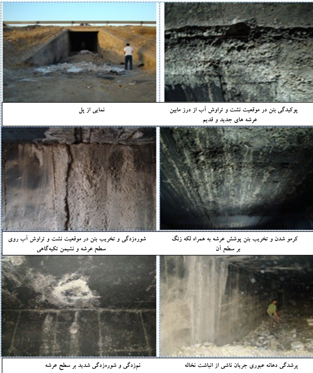
شکل ۲. بازرسی پل شماره ۵ در محور کرج- قزوین
