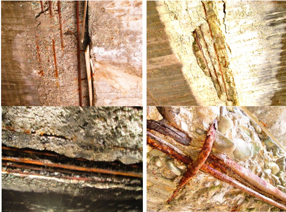
شکل ۳. تخریب بتن و رخنمون آرماتورها در اجزای باربر پل
