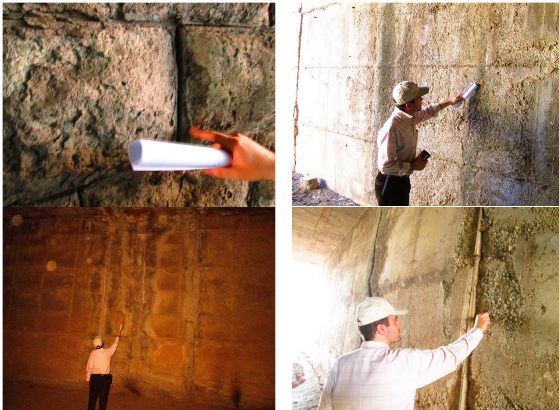
شکل ۵. شناسایی و علت‌یابی نشانه‌های آسیب در اجزای پل (مانند ترک‌ها، پوسیدگی‌ها و...)
