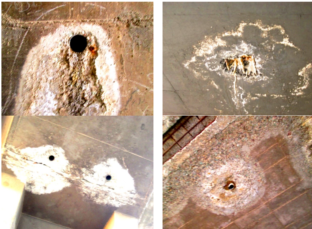
شکل ۴. مشکلات زهکش‌ها و اثرات ثانویه در پل‌ها
