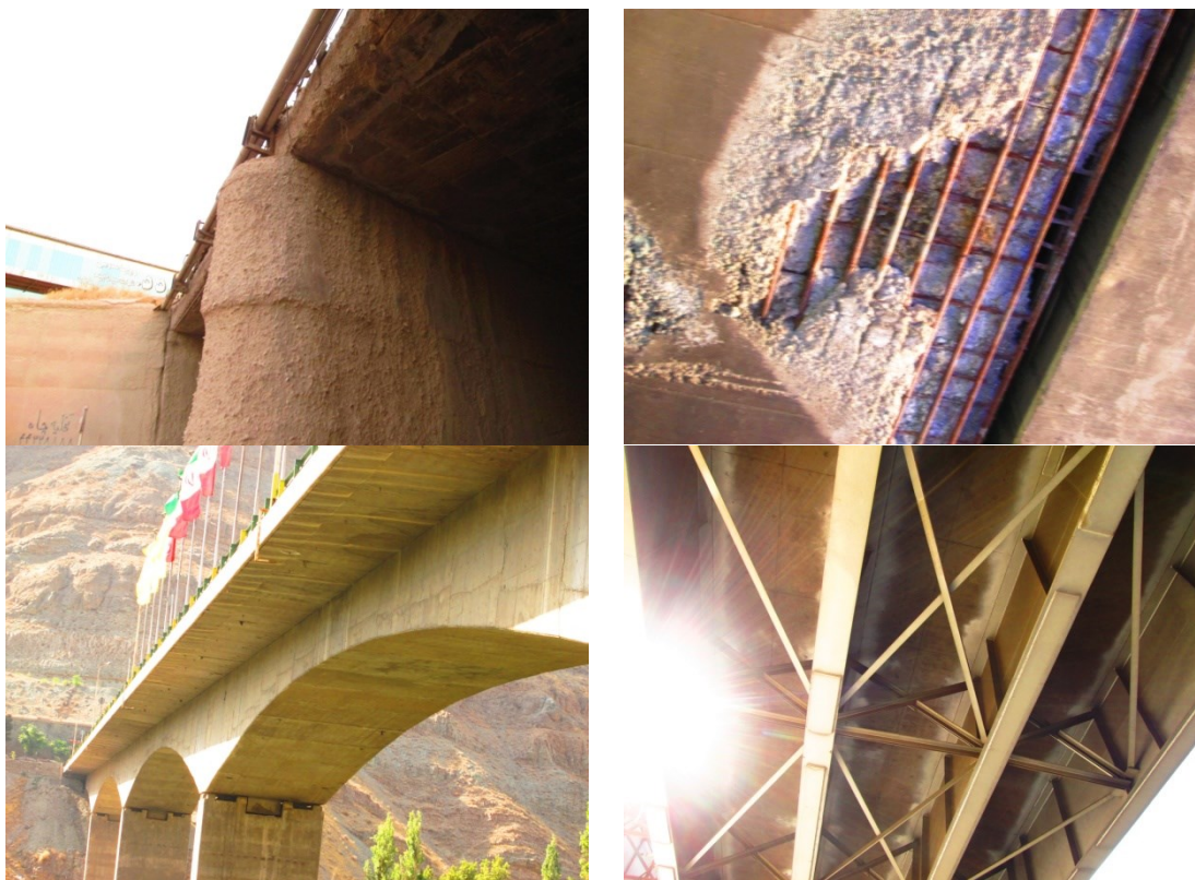
شکل ۶. بررسی وضعیت المان‌های اصلی و باربر سازه (تیرها، ستون‌ها، اتصالات، کلیدهای برشی)
