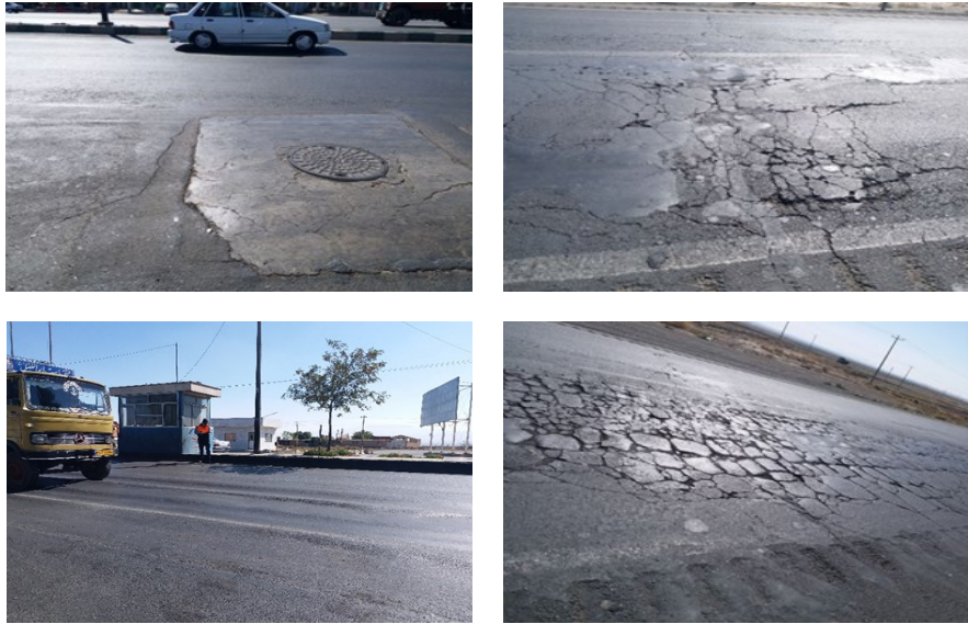
شکل ۳. نمونه خرابی‌های ثبت شده در قطعه شماره یک در ابتدای مسیر مورد مطالعه در جاده سبزوار- شاهرود
