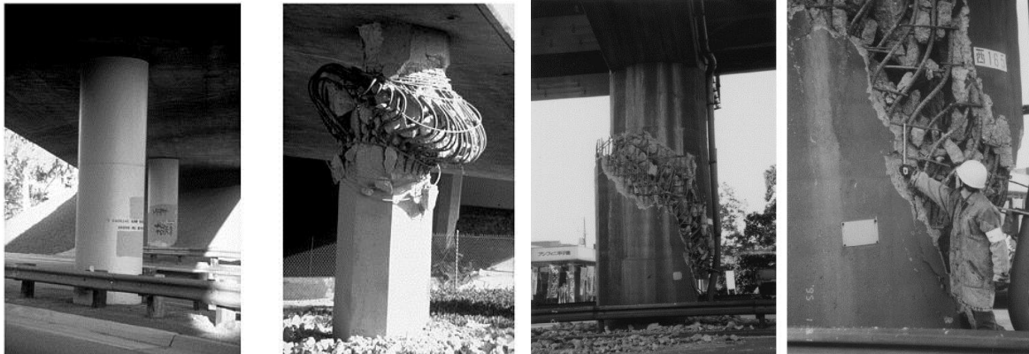
شکل ۲. نمونه‌هایی از شکست در پایه پل‌ها
