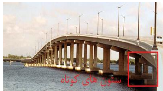
شکل ۱. وجود ستون کوتاه در پل‌های شیب‌دار
