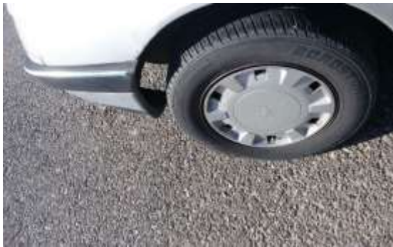
شکل ۳. روسازی با خرابی هوازدگی
