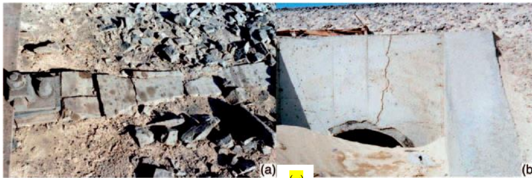
شکل ۲. نمونه‌ای از مشکلات خطوط راه‌آهن در نواحی سربری: الف) تخریب و انسداد ورودی پل‌ها و ب) تخریب تراورس بتنی (ذاکری و همکاران، ۲۰۱۱)
