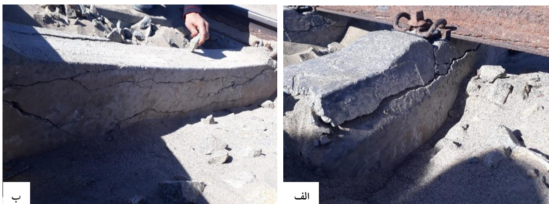
شکل ۹. گسترش ترک‌ها و تخریب تراورس
